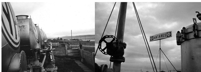
Planta de combustible instalada por YPF Antares.
