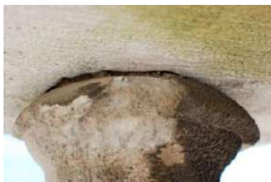
Figura 1. Fachada de la iglesia de Santa María de Belém, del Monasterio de los Jerónimos, Lisboa, Portugal. Las tres fotos muestran áreas que están protegidas de la lluvia directa. Sin
